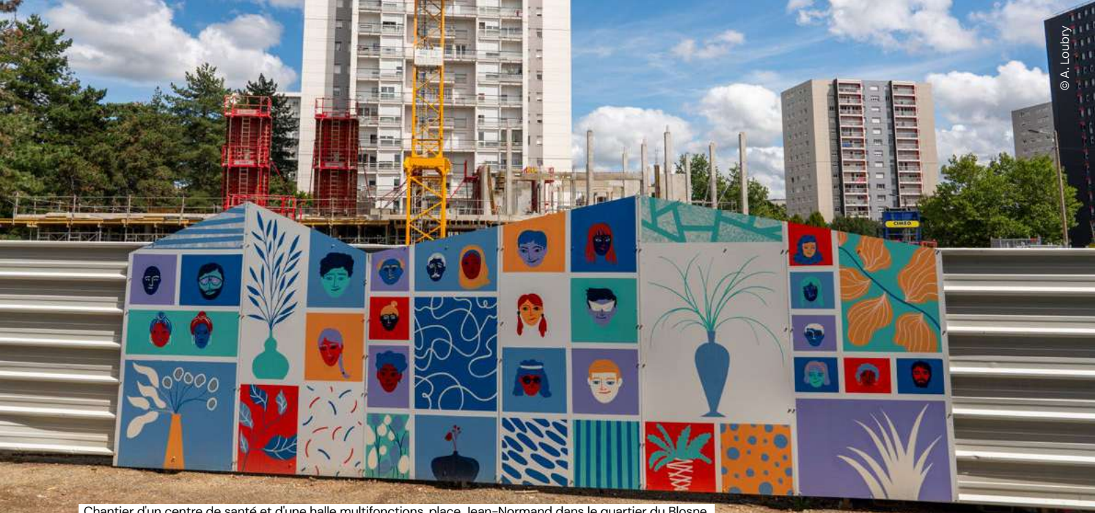
Chantier d'un centre de santé et d'une halle multifonctions, place Jean-Normand dans le quartier du Blosne.
