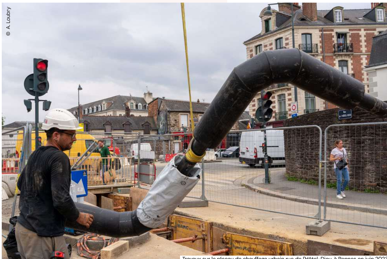
Travaux sur le réseau de chauffage urbain rue de l'Hôtel-Dieu, à Rennes en juin 2023.
